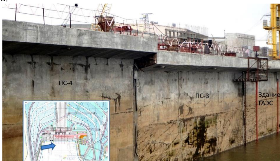
Рис. 1. Осадка здания Загорской ГАЭС-2 и подпорной стенки ПС-3 относительно подпорной стенки ПС-4
